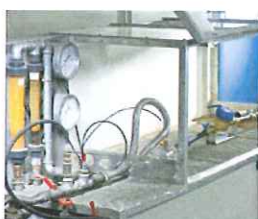
Banc d'essais hydrauliques
